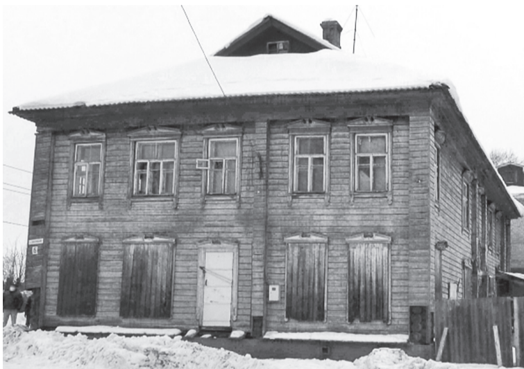
Здание конторы заповедника и недостроенной пожарно-химической станции заповедника. В таком же состоянии находятся здания музея природы (бывшей типографии), научного стационара (Варзенской школы). Тем временем заповедник все это время арендует помещение и ежегодно выплачивает за аренду половину от всей стоимости ремонта зданий. Без своевременного ремонта все здания пришли в негодность, кроме каменного здания музея природы.
